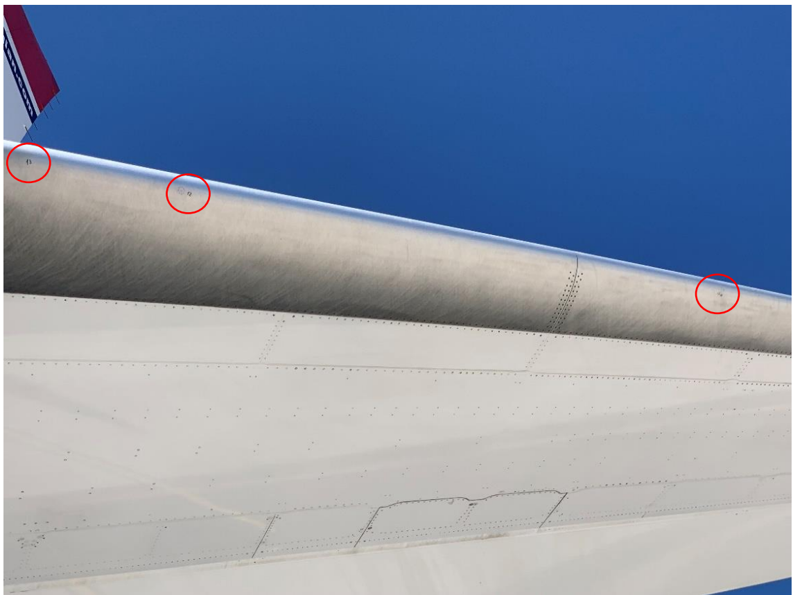
Foto 7: punti di danneggiamento esterni dello stabilizzatore orizzontale.
